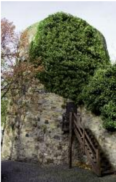
Dieses Bild des Dicken Turms, aufgenommen vor Beginn der Restaurierung, ziert die Bausteine zu 25, 50 und 100 Euro, die man beim Heimatverein „Ratinger Jonges“ erwerben kann, wenn man sich an der Finanzierung des großartigen Projektes beteiligen möchte. „Jeder Stein ist wichtig...“
